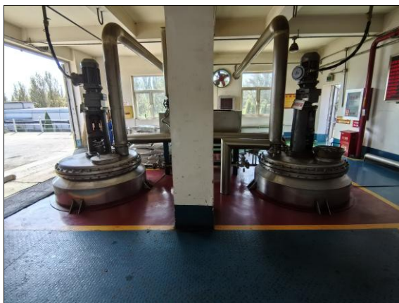
现有油相制备罐
