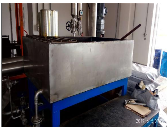
现有油相溶蜡槽
