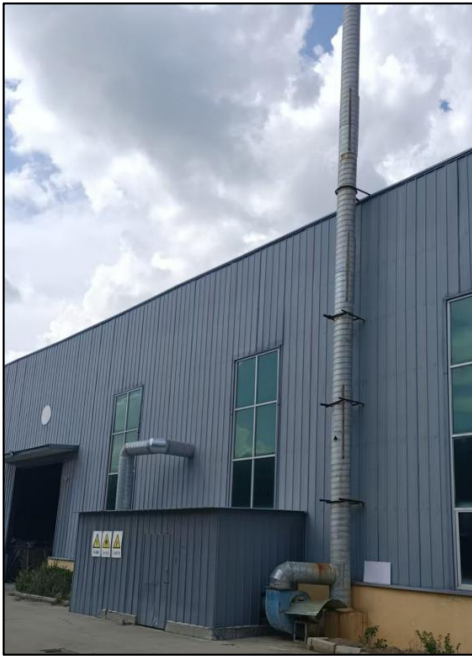
警示板 1#挤出组工序排气筒
