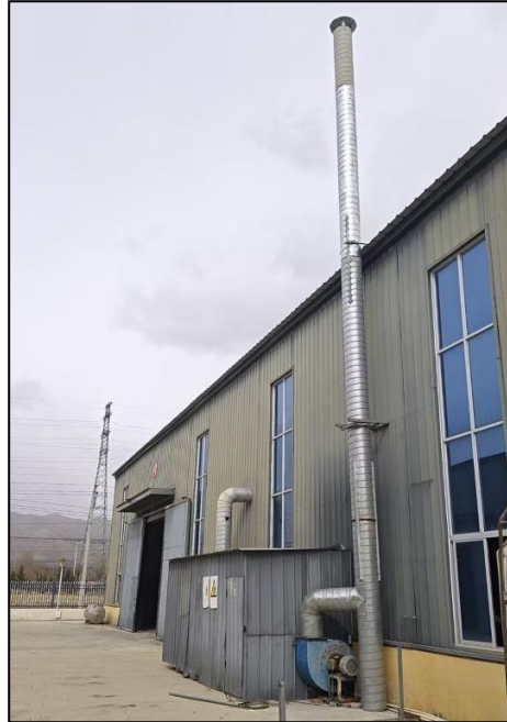
再生颗粒生产车间排气筒
