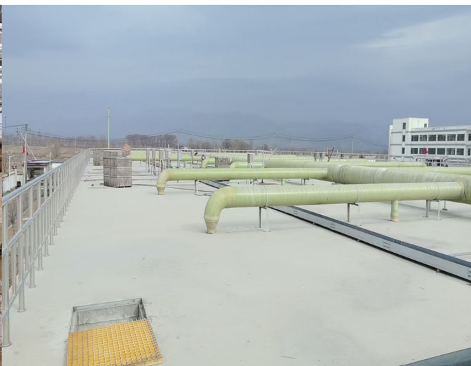
现有工程集气管道
