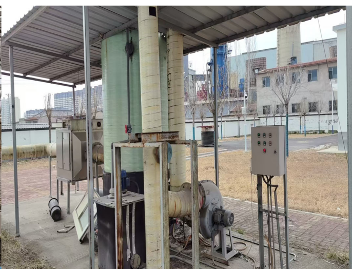
现有工程除臭装置
