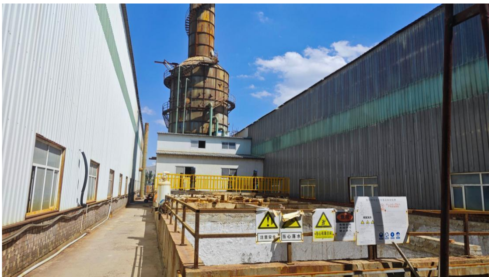
现有工程石灰-石膏法脱硫塔
