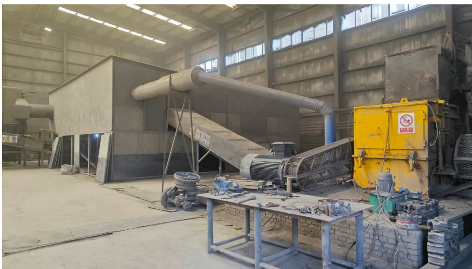
现有工程破碎筛分车间
