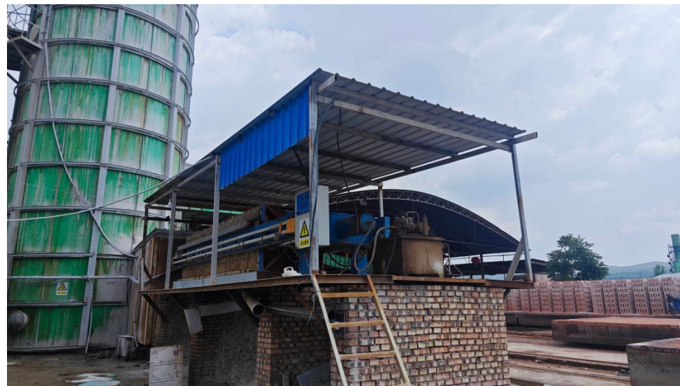
现有工程脱硫设施
