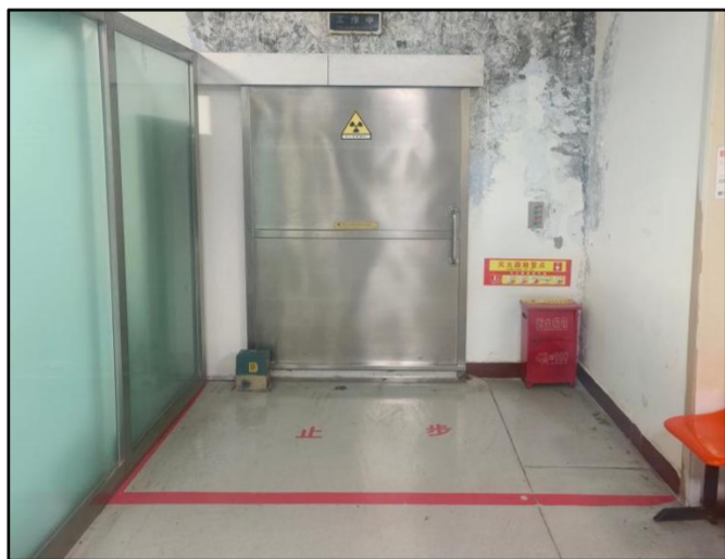
直线加速器 2 室东侧（机房门）
