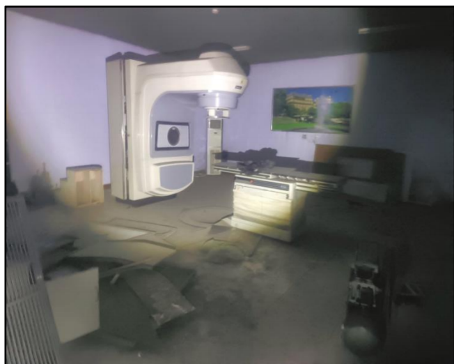
直线加速器 2 室
