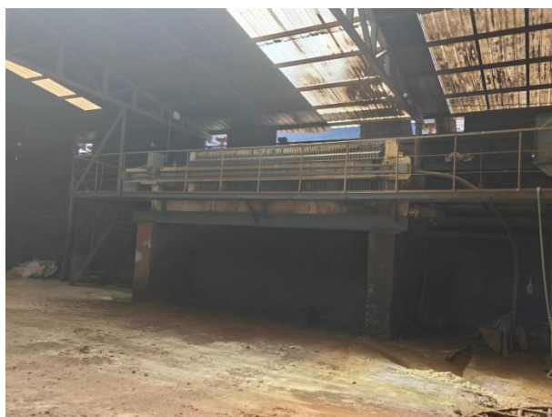
现有工程配套的压滤机
