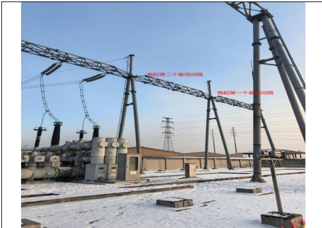
御东220kV变电站备用间隔
