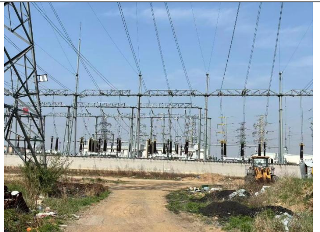
御东220kV变电站
