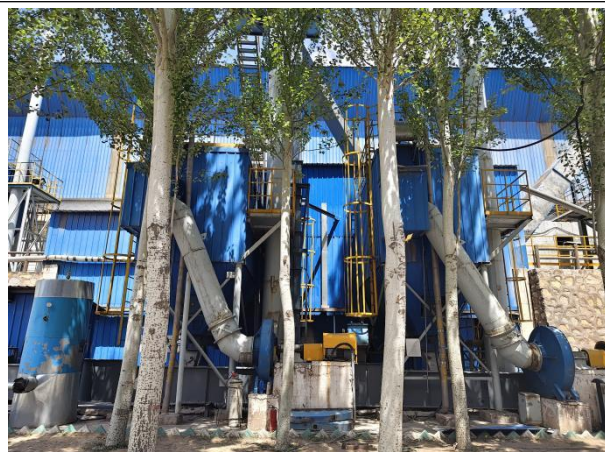
机制砂场地除尘器（利用现有破碎除尘器）
