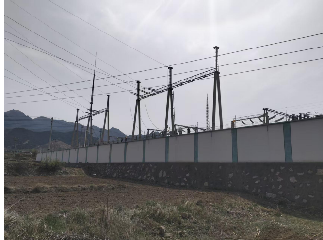
武灵 110kV 变电站 (北起第一间隔处)
